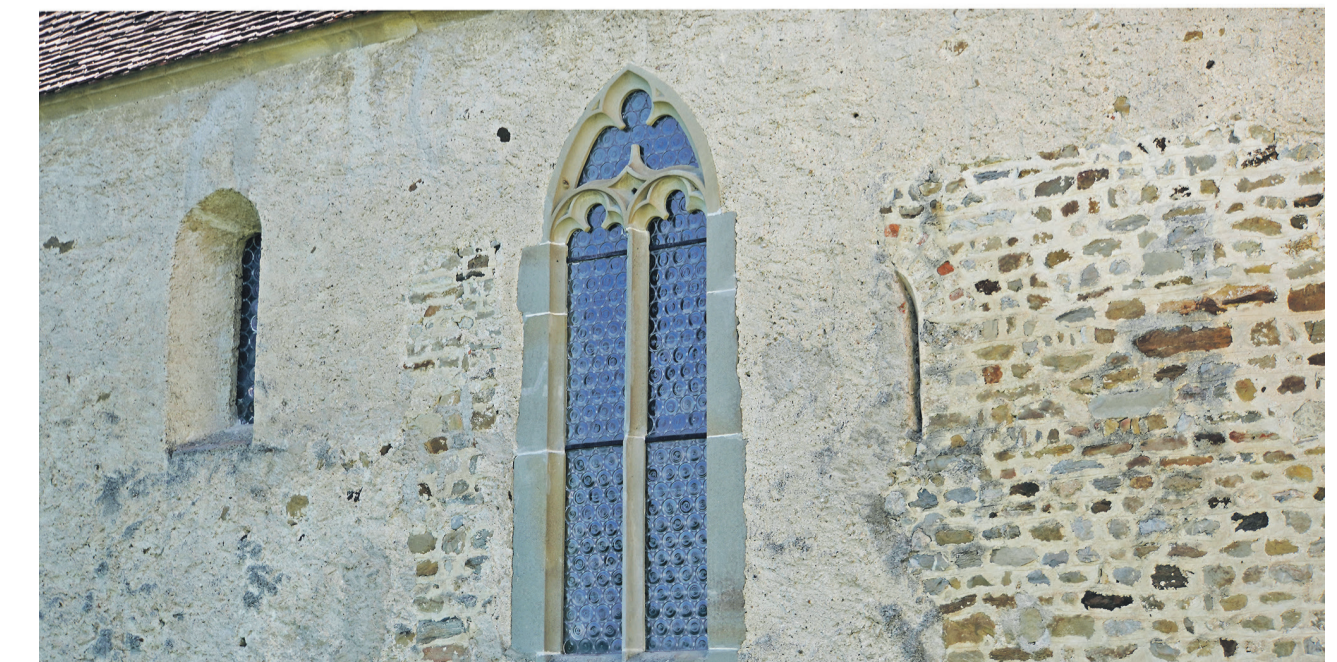
Spuren der Baugeschichte von St. Martin. Unten: Reste von verputztem Bruchsteinmauerwerk und Öffnungen aus verschiedenen Bauphasen. Oben: Steinmetzzeichen an den Gewölberippen im Chor und Abbundzeichen am Glockenstuhl im Turm.
